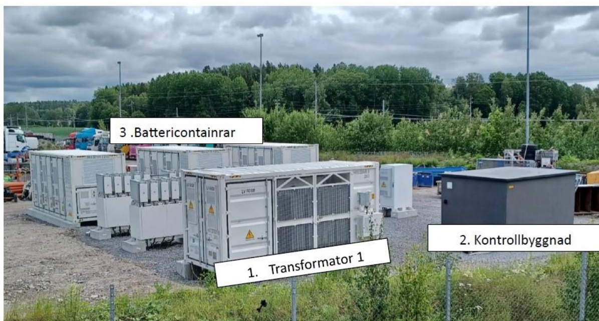
Exempel på område med batterilagring. På bilden syns 3 battericontainrar, 1 transformator i containerutförande och en mindre kontrollbyggnad/ställverksbyggnad.
