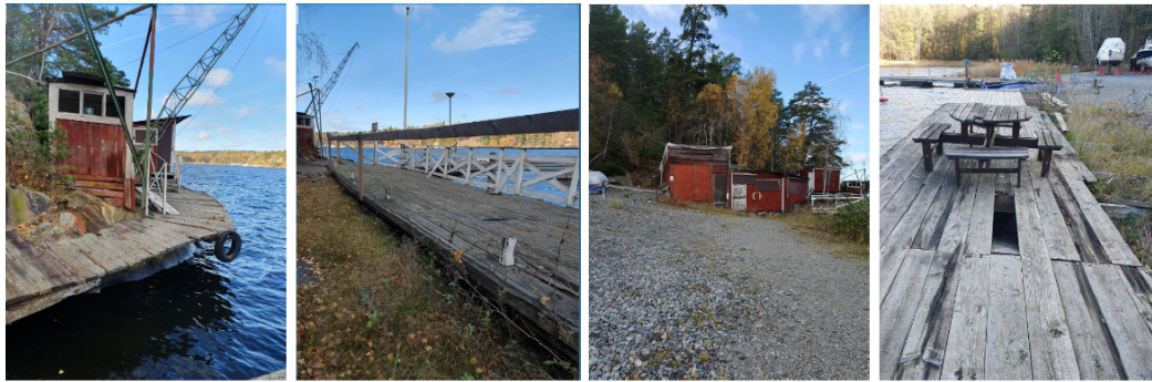
Från vänster: Brygga 1, 7 och byggnader som informeras avses stängslas in. Till höger, brygga 5 som uppgavs vara i sämre skick.
